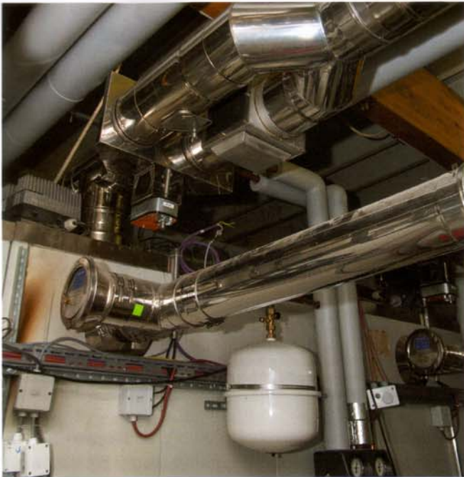
Ein Wärmetauscher mit einem Bypass. Kann man keine Wärme abführen, wird das Rauchgas am Wärmetauscher vorbei geführt, um diesen nicht zu überhitzen.
