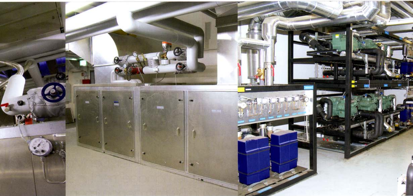
Beispiele von sinnvoller Energietechnik in einer modernen Bäckerei. Von links: Eine durchdachte Gebäudearchitektur erlaubt es die natürliche Thermik zwischen warmen und kühlen Bereichen für das Luftmanagement zu nutzen, Warmwasserspeicher für Heizung und Spülmaschine, Wärmetauscher im Rauchgasabzug eines Gasbrenners, Regulierung der Atmosphäre (Temperatur, Feuchtigkeit) in den verschiedenen Produktionsbereichen und Wärmetauscher an Kältemaschinen für Fußbodenheizung.
