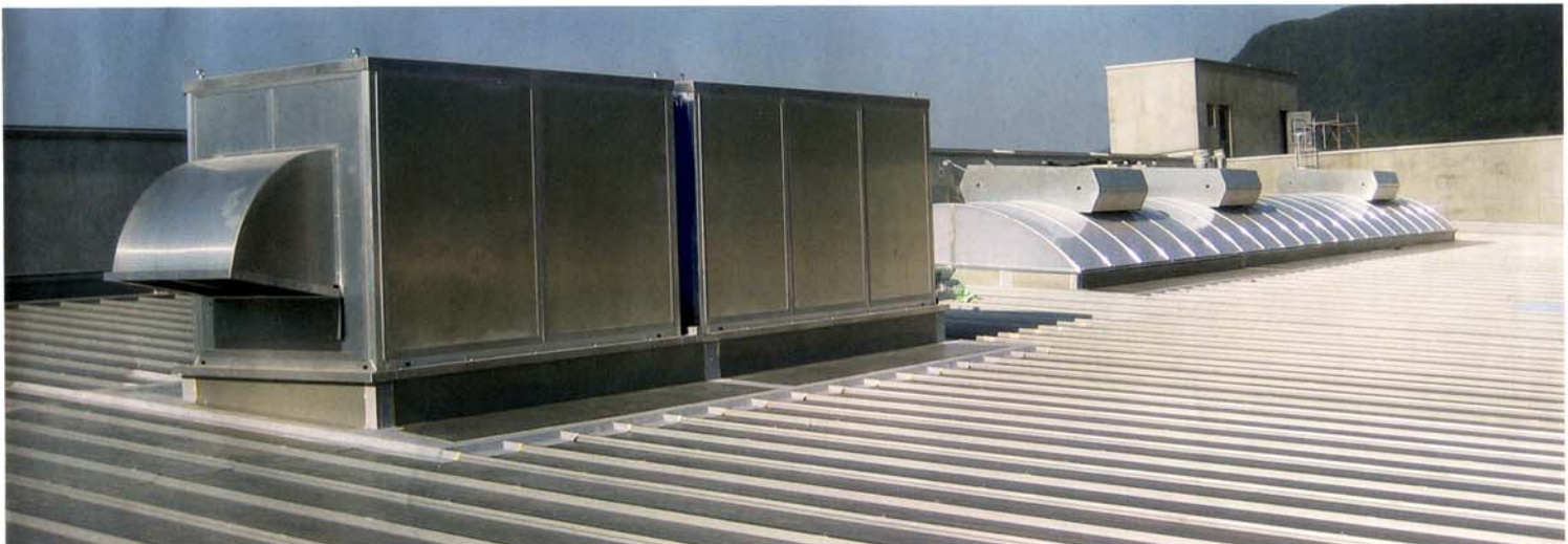
Oben: Natürliche Be- und Entlüftungsanlage.
