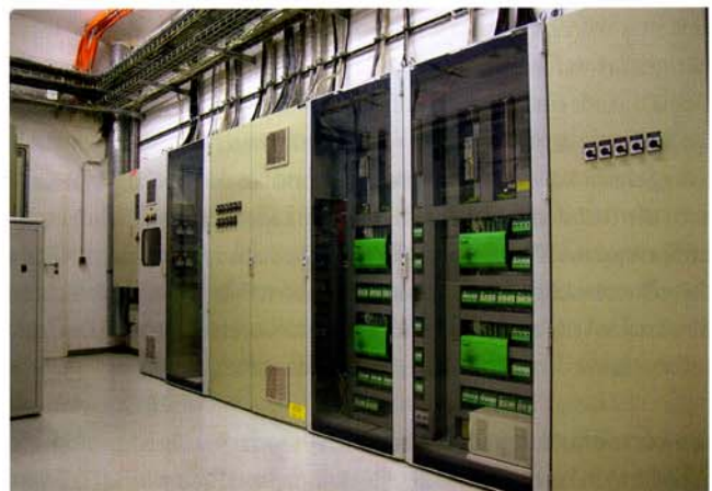
Die Regelungen der gesamten Anlagentechnik sind zentral untergebracht. Nur dadurch wird eine übergreifende Administration möglich.
