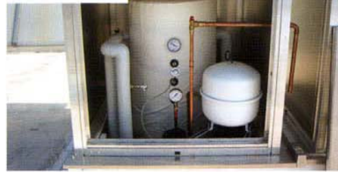
Integrierter Pufferspeicher zum Ausgleich von Abwärme- und Luftbedarfsschwankungen.
