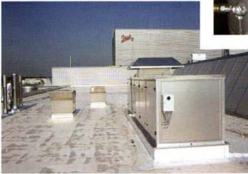
Über den langen Aufbau rechts gelangt Frischluft in das Klimasystem. Die angesaugte Luft wird gefiltert und gegebenenfalls erwärmt.
