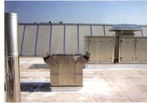
Frequenzgeregelte Ventilatoren auf dem Dach passen Ihre Leistung der benötigten Luftmenge an.
